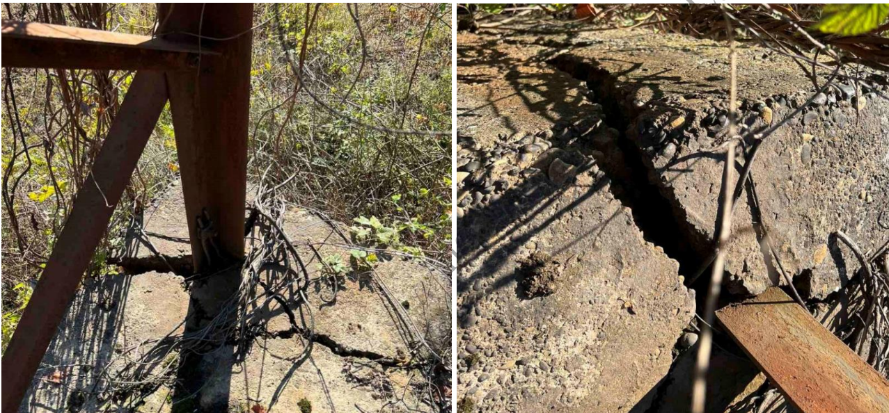
Fotografije oštećenja na stubu SM 12
