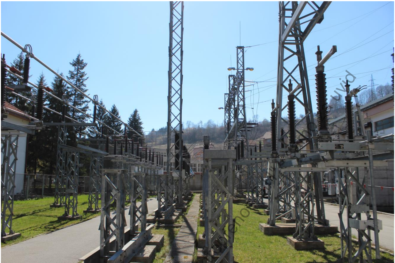
Slika 1. Linijski rastavljač, temelji i čelična konstrukcija za prekidač i SMT
