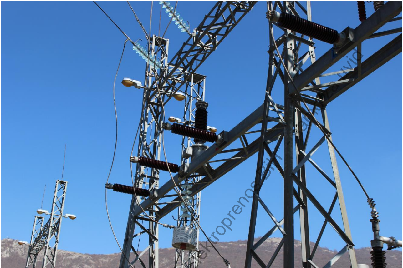
Slika 3. DV 110 kV Jelovača
