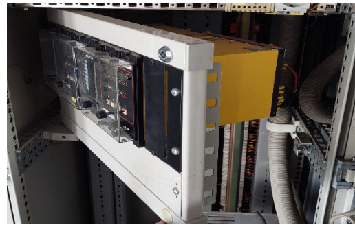
Prostor dostupan za ugradnju novog releja:
